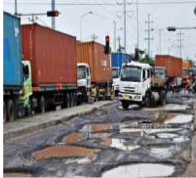
Salah satu jalan yang penuh lubang di Kota Semarang (Solopos, 26/2/2018).
